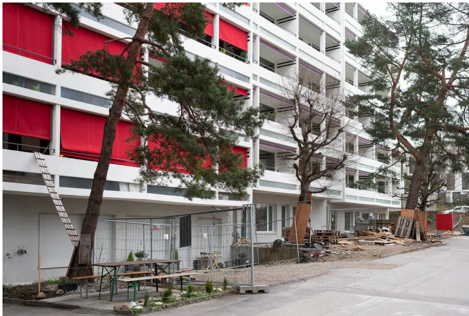
Das Haus an der Giacomettistrasse 4 (links) ist bereits bezogen, das Gebäude nebenan ist noch im Umbau. (Bild: Danielle Liniger)
